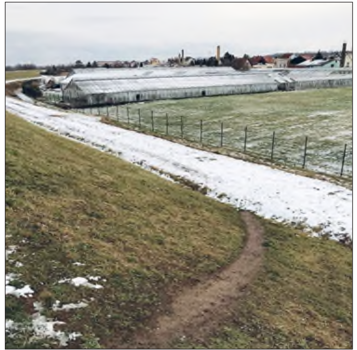
Deich Gohlis – die beschädigte Grasnarbe unterhalb der Deichscharte Windmühlenweg (Bildquelle: Umweltamt Dresden).
